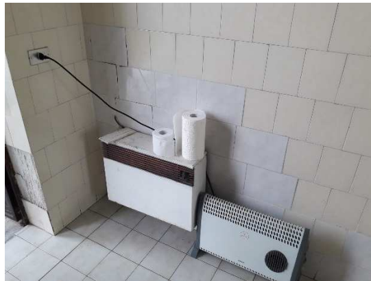
Figura 3: Termoconvettore e particolare delle piastrelle di rivestimento
